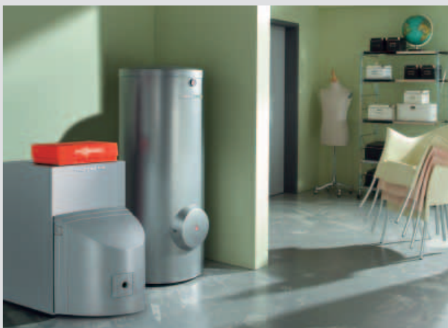
Vitorond 100 con interacumulador vertical Vitocell-V 300 situado al lado de la caldera
